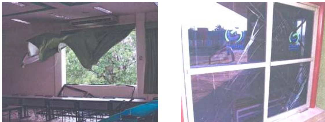
Figura 2.84 Ejemplo de daños en infraestructura de salud en el municipio de Campeche
