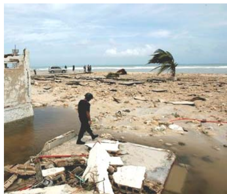
B. Daños en construcciones cercanas a la costa
