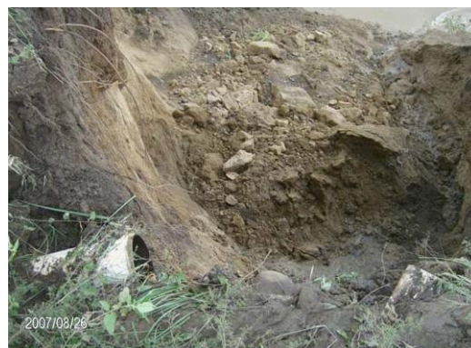
Figura 2.114 Daños en líneas de conducción de 14 pulgadas
