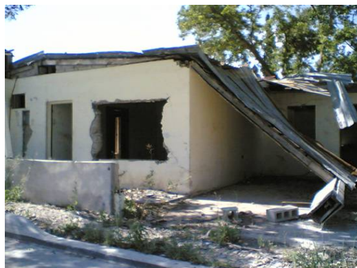
Figura 2.331 Vivienda con daño en techos, cancelería y puertas
