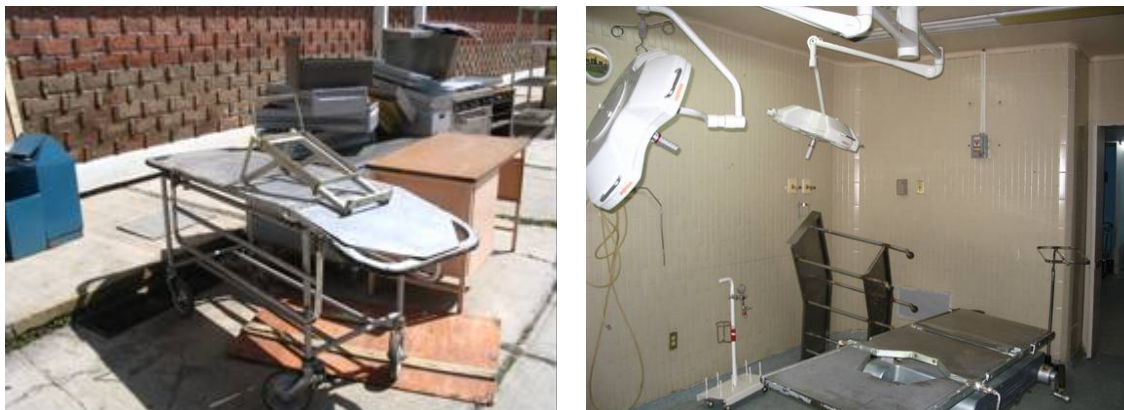
Figura 2.164 Daños en equipo médico y en el quirófano del Hospital Tulancingo
