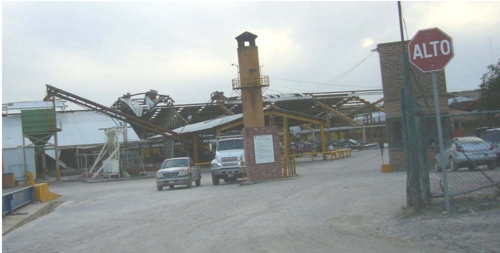
Figura 2.314 Daños a techo de ladrillera en Villa de Fuente
