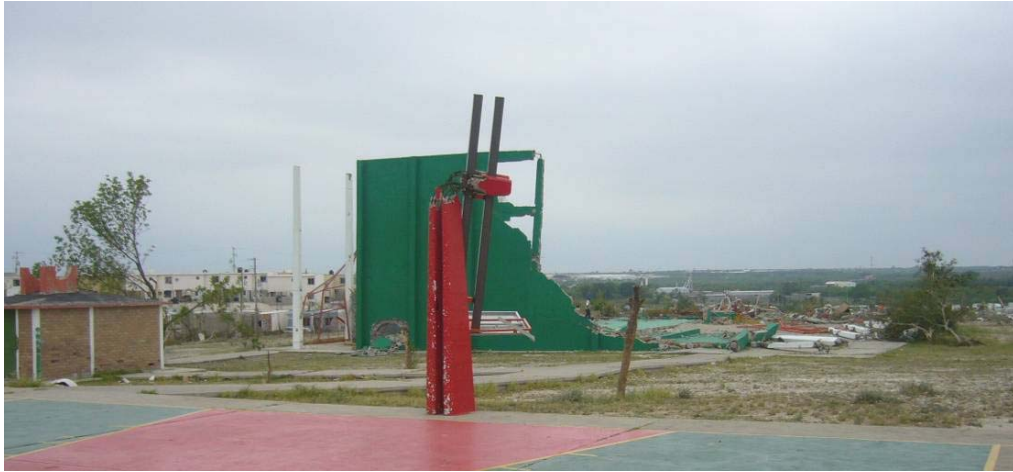
Figura 2.311 Daños en muros de frontón e incluso vallas de deportivo. Nótese que también hubo daños a los postes que sostienen las canastas en la cancha de basquetbol
