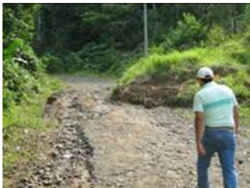
Figura 2.277 Camino rural afectado en su superficie de rodaje, así como por derrumbes
