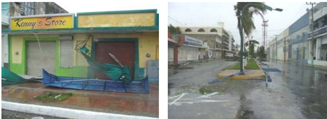
Figura 2.56 Daños por viento en Chetumal, Quintana Roo
