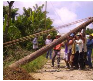
Figura 2.283 Poste ladeado a consecuencia del reblandecimiento de terreno
