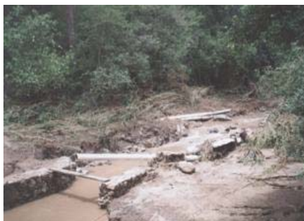
Figura 2.139 Daños en líneas de conducción en el municipio de Zacatlán
