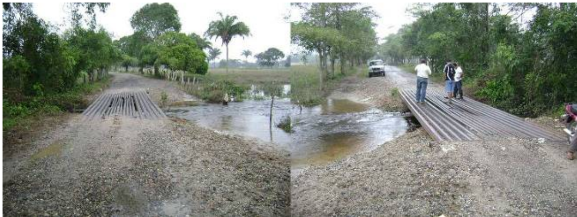
Figura 2.249 Daños en puentes. Daños en el puente tubular vehicular del camino Zanapa, segunda sección, kilómetro 3 + 400, municipio de Huimanguillo
