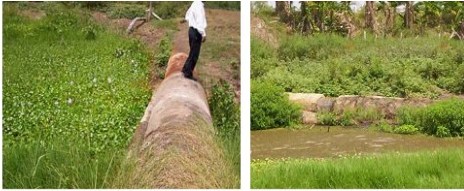
Figura 2.207 Ductos de PEMEX que al cruzar corrientes de agua reducen su sección hidráulica
