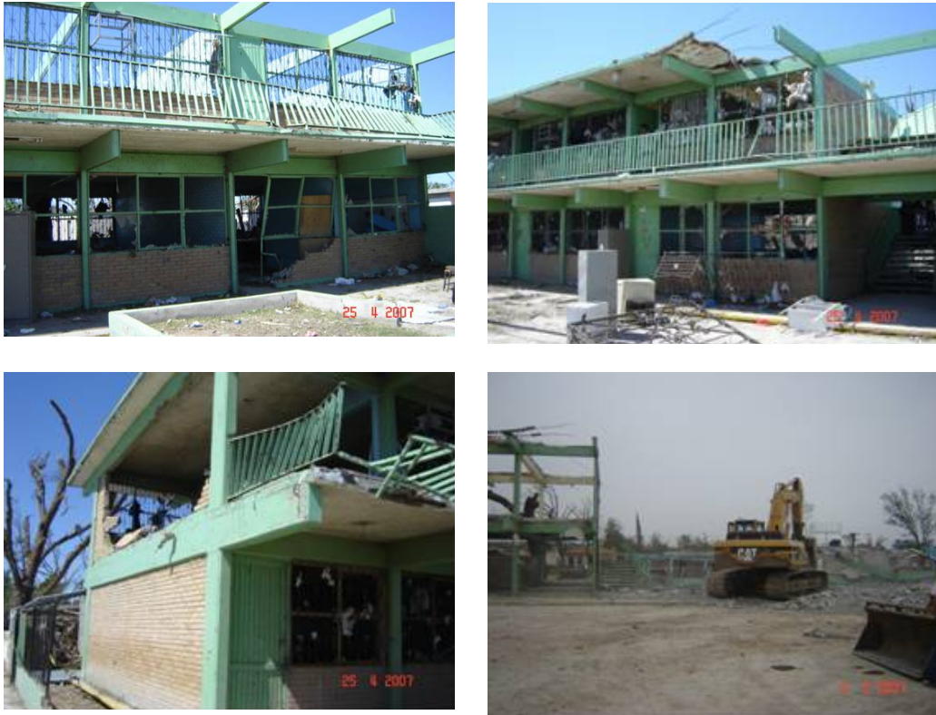
Figura 2.337 Daños ocasionados por el tornado en la Escuela Primaria Centenario
