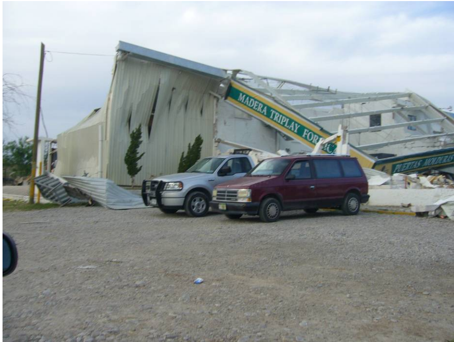
Figura 2.309 Falla de techos en bodegas
