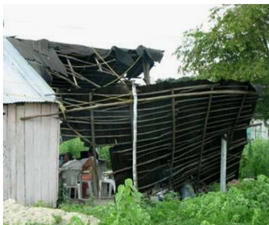
Figura 2.82 Daño en techo de vivienda del municipio de Champotón
