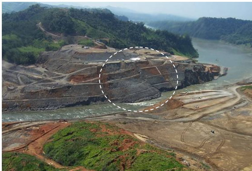
Figura 3.23 Falla de un talud en la margen izquierda del canal, marzo 2008
