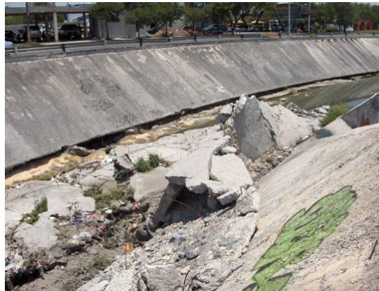
Figura 2.15 Daños en el revestimiento del piso del arroyo Topo Chico
