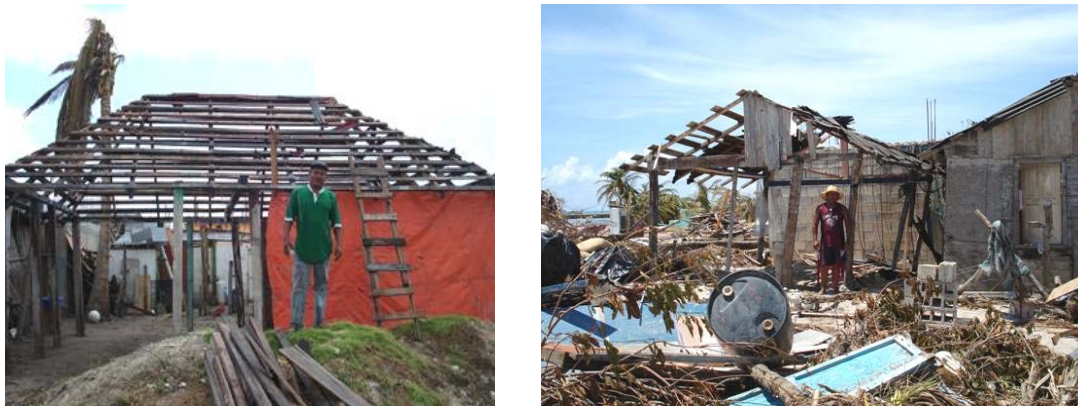
Figura 2.60 Viviendas de estructuras endebles afectadas por el huracán Dean en la localidad de Mahaul
