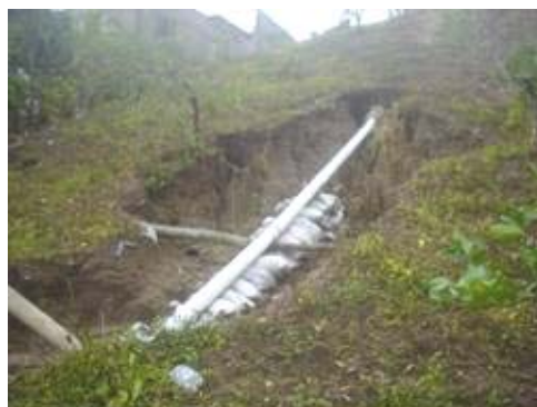
Figura 2.132 Deslizamiento en un camino rural en el municipio de Cuautempan
