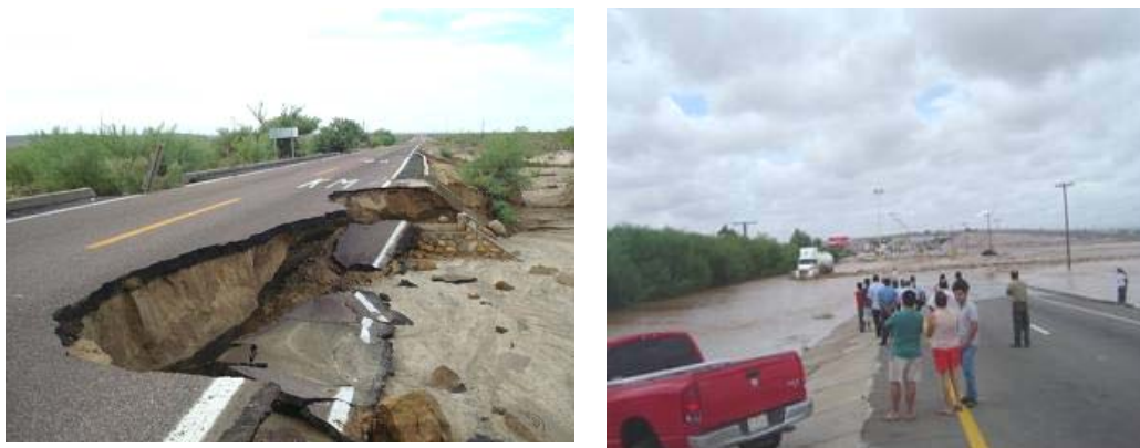
Figura 2.186 Ejemplos de daños en carreteras en Baja California Sur
