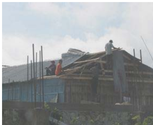
Figura 2.81 Afectaciones en techumbre de templo en el municipio de Champotón
