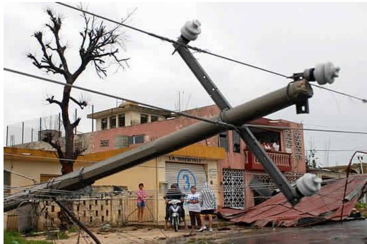
Figura 2.65 Daños en el sector eléctrico en la ciudad de Chetumal por Dean
