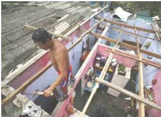
A. Desprendimiento de techos
