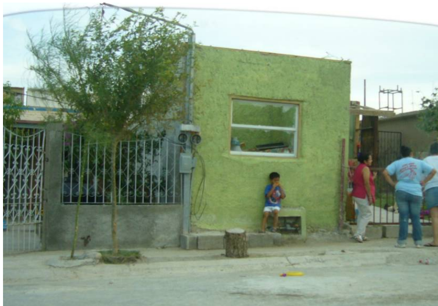
Figura 2.310 Estallamiento de ventanas (colonia El Deportivo)
