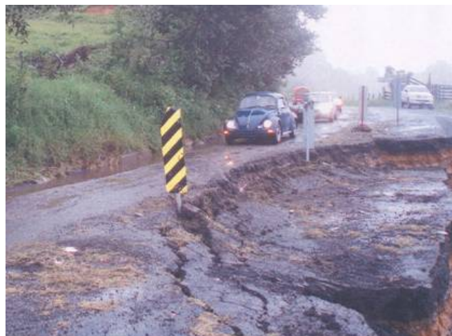
Figura 2.170 Daños en la infraestructura carretera del estado de Hidalgo a consecuencia del ciclón tropical Dean
