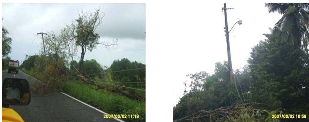
Figura 2.42 Daños en postes y líneas de distribución eléctrica en el municipio de Tapachula
