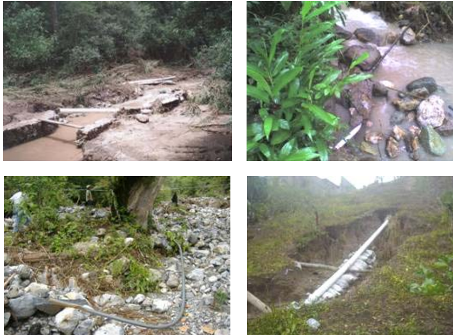
Figura 2.131 Daños en la infraestructura hidráulica
