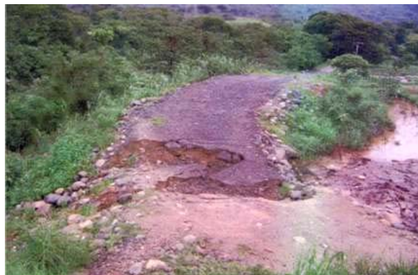
Figura 2.41 Daños en camino del municipio de Huixtla
