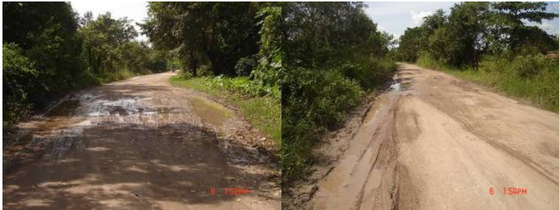
Figura 2.248 Daños en caminos rurales. Daños en el camino Pejelagarto – Palo Mulato (plataforma Buena Vista), en el municipio de Huimanguillo
