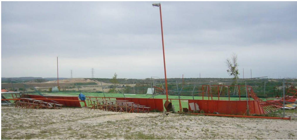
Figura 2.312 Daños a muro perimetral en deportivo
