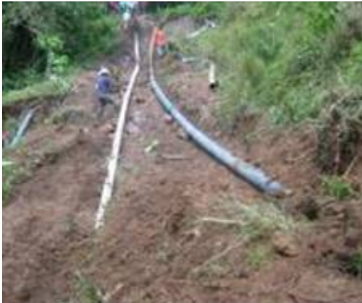
Figura 2.275 Daños en infraestructura de agua potable del municipio de Chicoasén
