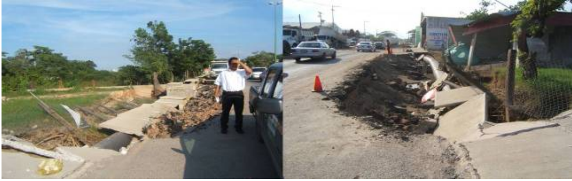
Figura 2.247 Daños en caminos pavimentados. Daños en el camino Periférico Carlos Pellicer Cámara, tramo de la glorieta Carlos A. Madrazo al Puente Tec Milenio, en el municipio Centro
