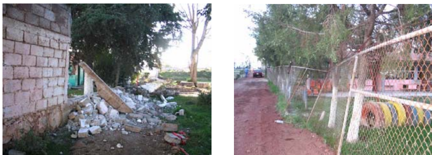
Figura 2.165 Daños en bardas perimetrales de algunos planteles de educación básica en el municipio de Tulancingo
