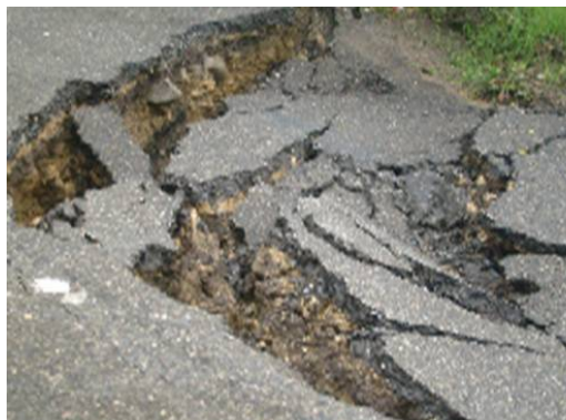
Figura 2.278 Deterioro de la carpeta asfáltica a consecuencia de las lluvias
