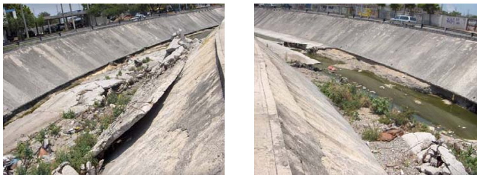
Figura 2.16 Daños en el revestimiento del arroyo Topo Chico
