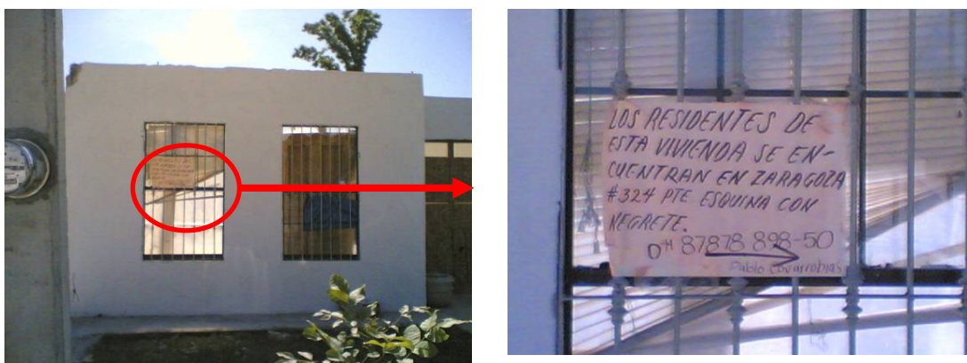
Figura 2.325 Vivienda dañada en Villa de Fuente con información de la ubicación de los residentes, los cuales fueron afectados por el fenómeno
