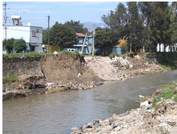
Figura 2.167 Daños sobre el cauce del Río Chico de Tulancingo
